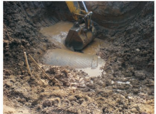
哈尔滨市某水库爆管现场
